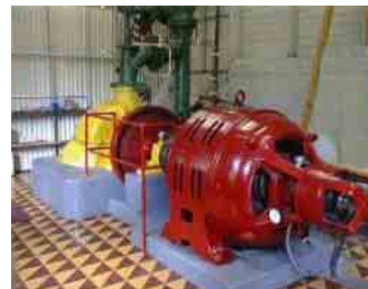
Figura 79: vista interna de la maquinaria de la planta Avance, San Ramón de La Unión. Obsérvese que el edificio conserva el piso de mosaico original que data de su construcción en la década de 1930
