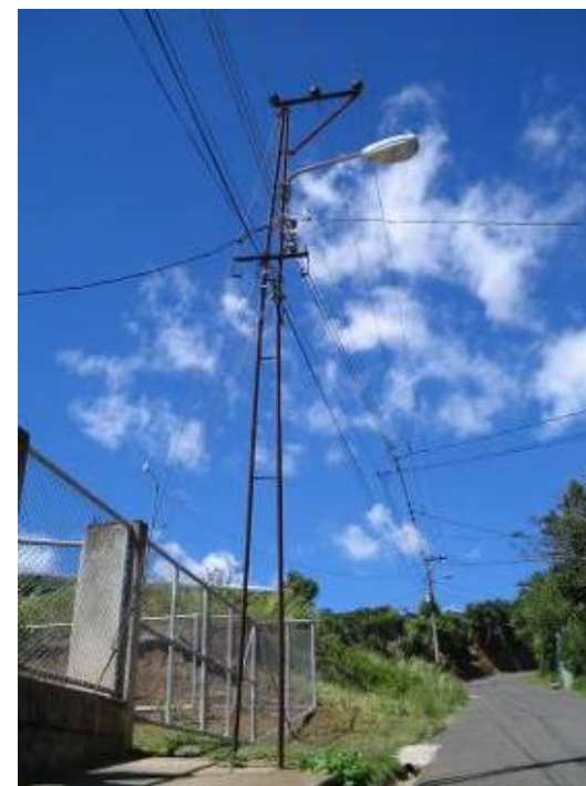
Figura 78: Poste eléctrico en San Rafael
